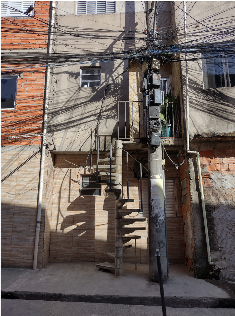
Figura 6: Sobrecarregamento das infraestruturas em Heliópolis.
