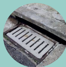
Bocas de lobo
