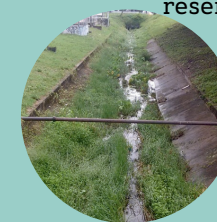
Valas de drenagem/ de infiltração
