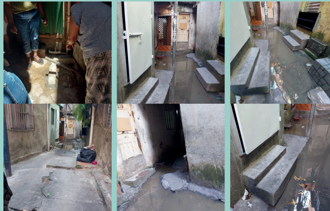
FIGURA 29. Problema de microdrenagem na viela Sta. Luzia
